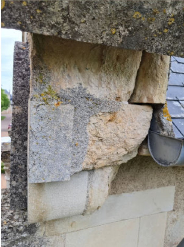
86. ← Console sous le rampant côté sud du pignon ; les blocs en façade, ici à gauche, ont été remplacés en 1962. Les autres blocs sont aussi abimés que les blocs symétriques figure 51 page 13. Le plâtre à l'origine de la désagrégation n'a pas été éliminé lors de la restauration 1962, dissous par l'eau des nombreuses infiltrations (figure 87), il continue d'abîmer la pierre. 20220913_170647
