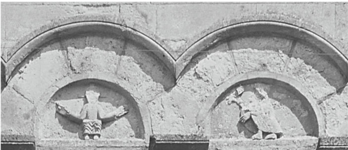
139. ↑ Avant 1932, Georges Estève, source MPP 10I06352 recadré (la photo de la façade entière n'est pas présentée dans ce rapport). En moins de vingt ans, la situation semi-abritée des claveaux et des reliefs a entraîné des dommages considérables dus aux sels solubles.
