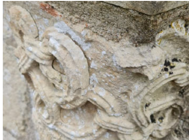
89. ↑ Vue plongeante sur le 5 ème chapiteau, même type de fissures, 20220915_135527
