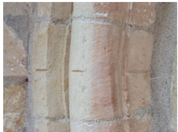
28. ↑ Faux joint gravé dans un claveau à gauche dans la voussure du portail. On note aussi la rubéfaction de la pierre (rougissement sous l'effet d'un feu intense) 20220916_102425
