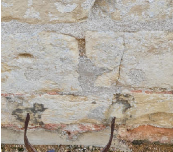
29. ← Localisation des photos suivantes dans le joint vertical au-dessus du fer à décrocher les sabots à gauche du portail pour localisation des photos ci-après 20220916_163836
