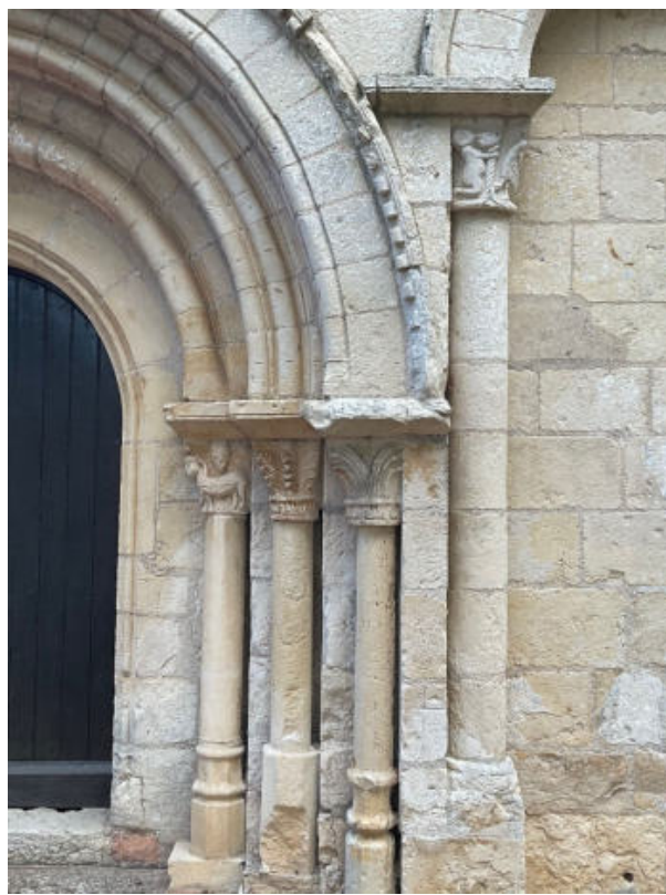
113. ↑ 15/9/2022, la colonnette intérieure, sa base et son socle ont été remplacés en 1962, les pertes sont importantes sur le bandeau à billettes du rouleau d'archivolte et sur la base de la colonnette centrale posée vers 1900, elle devait être bien moins abîmées en 1962 puisqu'elle n'a pas été remplacée. Photo Estelle Castelli
