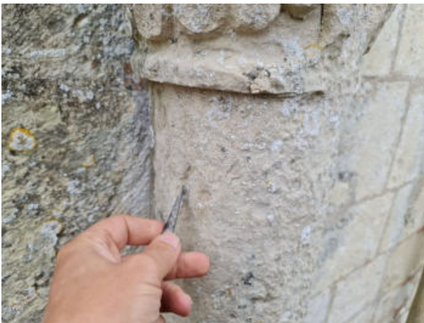
9. ← Prélèvement de pierre du bloc de la 1 ère colonne et du chapiteau haut à gauche, pierre de Charly supposée d'origine 20220915_105502
