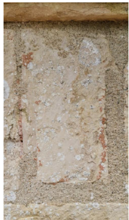
26. Le 11 ème fantôme des 13 modillons bûchés (ou 12 ème sur 15 ?) sous la corniche, entre la 5 ème et la 6 ème colonne. Des restes de mortier de tuileau couvrent aussi bien la partie bûchée, au centre, que l'épiderme d'origine autour. 20220915_135919
