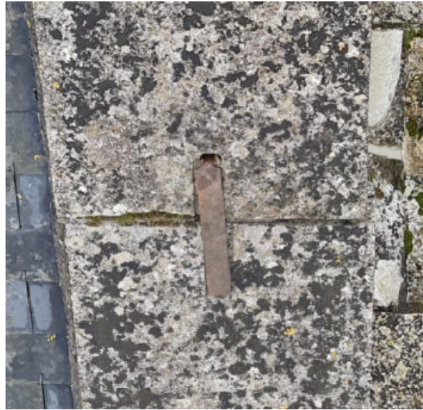
68. ↑ Un cochet de fer retient la dalle inférieure, le joint est largement ouvert côté droit, comme beaucoup de joints des deux rampants. 20220914_094218
