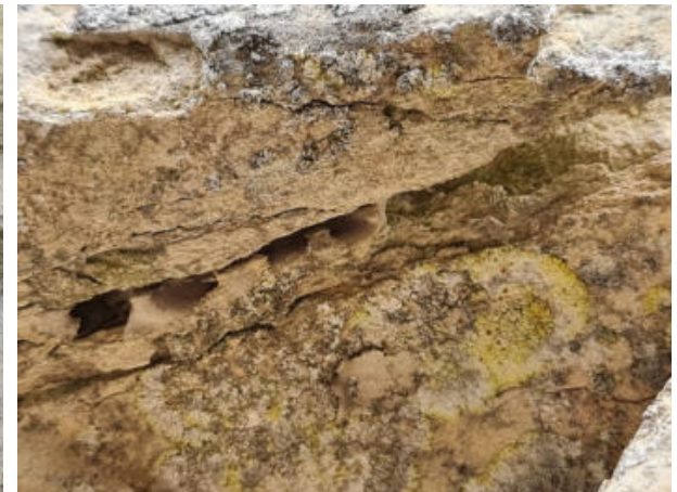
66. ↑ Vue en contre-plongée du cadre du 5 ème relief, grossi deux fois environ : fissure ancienne partiellement remplie de ciment blanc avec de nombreuses bulles d'air. La poursuite de l'altération par les sels solubles a continué d'ouvrir la fissure, créant de nouvelles fissures plus étroites entre pierre et ciment blanc 20220914_171804
