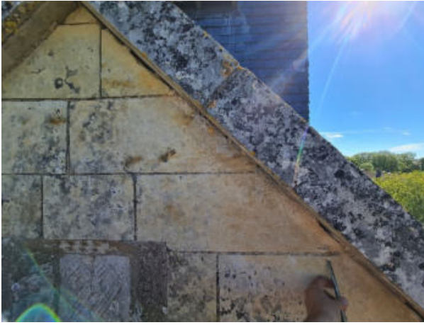
19. ← En bas à droite, prélèvement de la pierre de parement du pignon 20220912_113129
